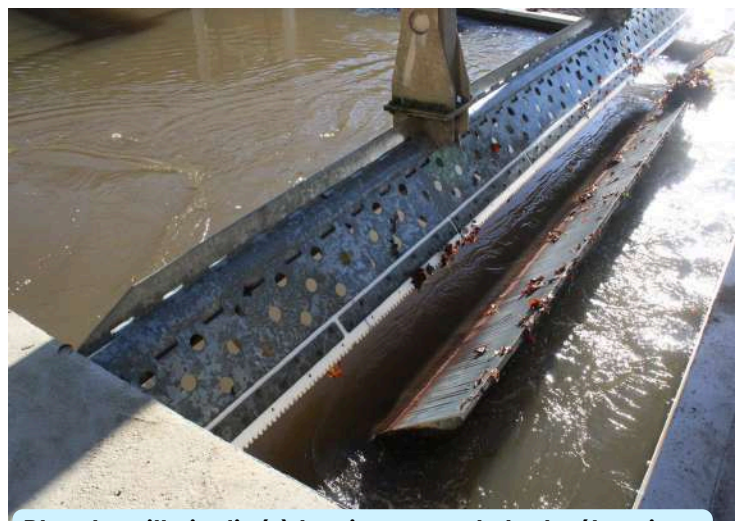
Plan de grille incliné à la microcentrale hydroélectrique de Roquenoubal à Compolibat
