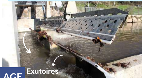
Exutoires sur la microcentrale hydroélectrique de Roquenoubal à Complobat (plan de grille incliné)
