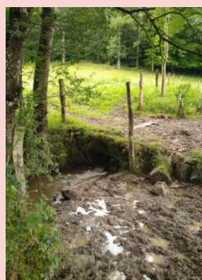
Buse sous passage agricole
