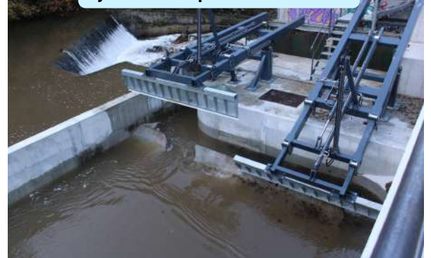
Dégrilleurs télescopiques sur la microcentrale hydroélectrique de Ramouillet
