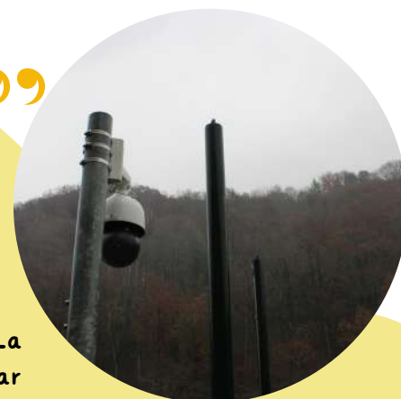
Système de vidéosurveillance sur l'ouvrage de la Ferrière
