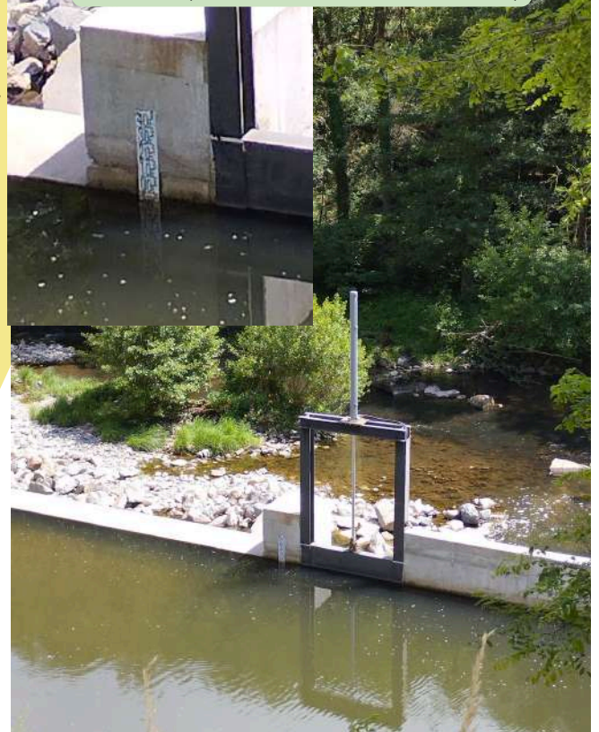
Echelle limnimétrique au niveau du moulin de Crémou (Villefranche-de-Rouergue)
