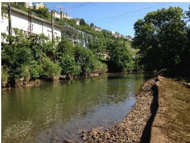
Figure 33 : Diminution de l'alimentation en eau par phénomène d'écluse en amont (Rodez Agglomération)
