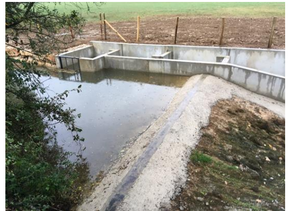
Ouvrage de répartition des débits et passe à poisson, Trou du Souci – Causse Aubrac
