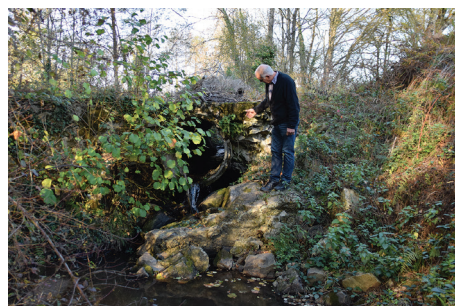
Érosion en sortie de buse perchée (Lunac)
